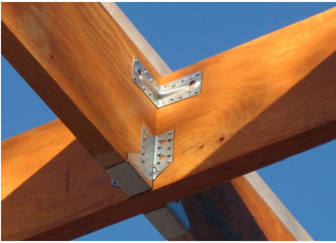
Almindelige bjælkesko og et vinkelpar i toppen. Dermed er både styrke og kæntring hindret.
